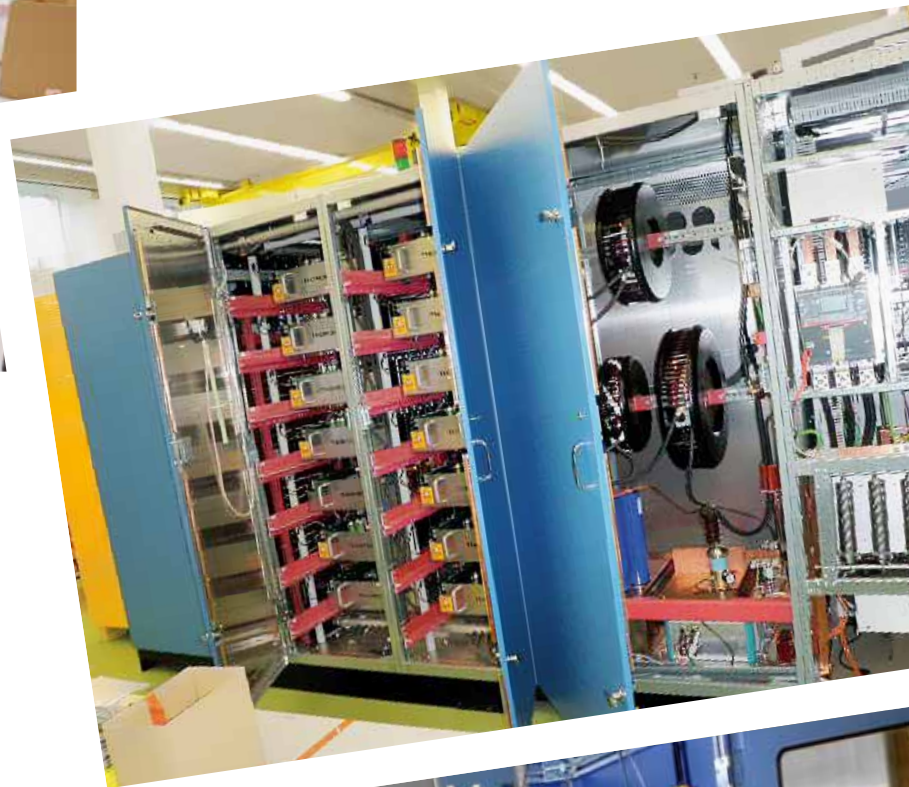
oben: DESY Schaltschrank unten: Prüfung der DESY Module
